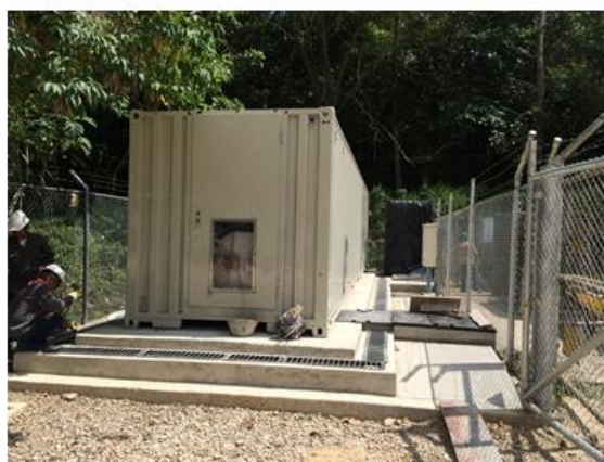
Imagem 4 : a unidade NO BREAK em seu local final
